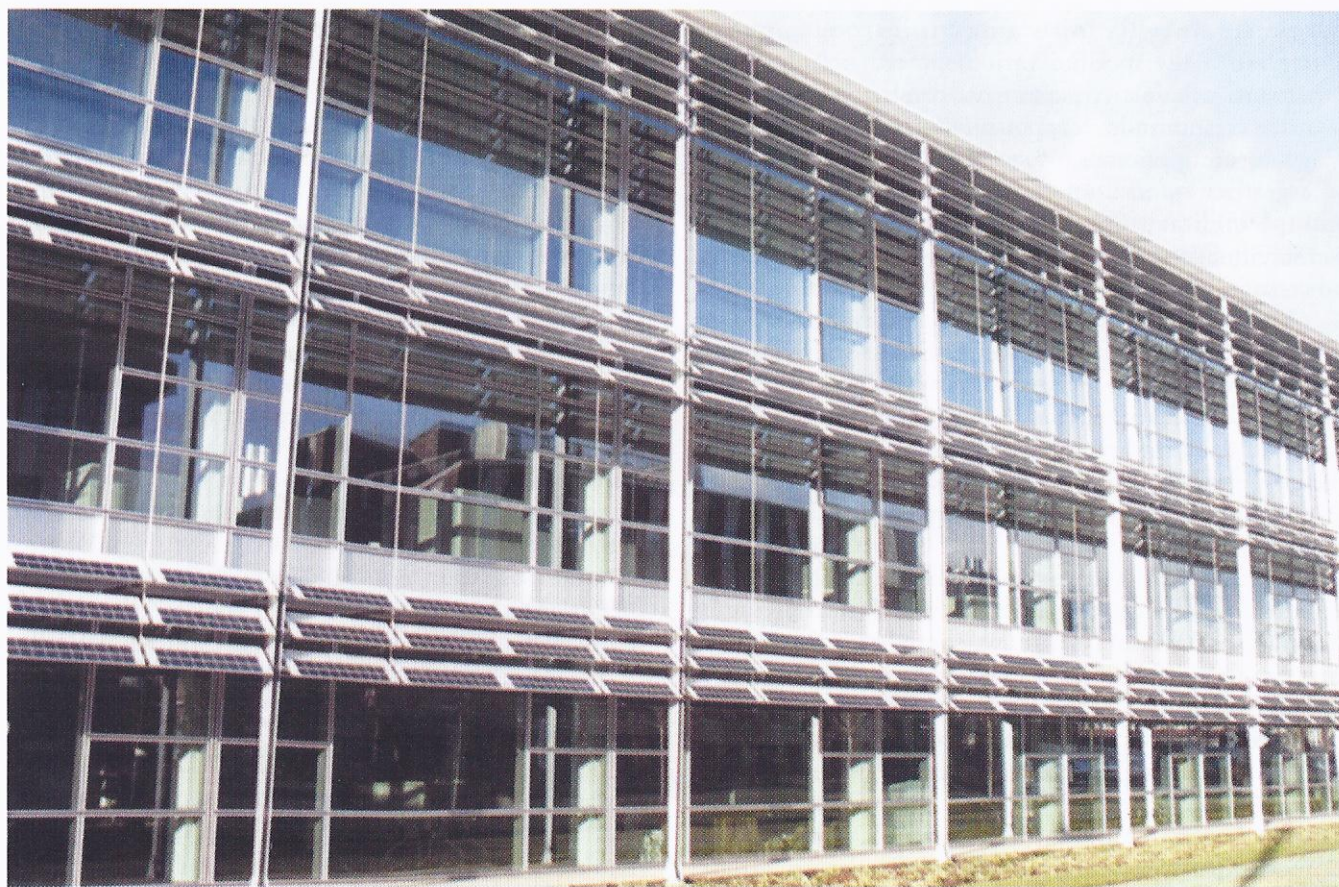
Sistema frangisole con moduli fotovoltaici in Sanbury building - Inghilterra
