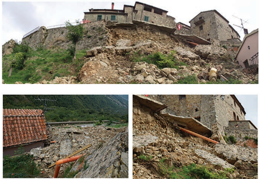
Figura 8. Il crollo delle mura di Cana di Roccalbegna. Il crollo visto dal basso (in alto), vista dalla piazzetta soprastante (in basso a sinistra), dettaglio visto dal basso (in basso a destra).
