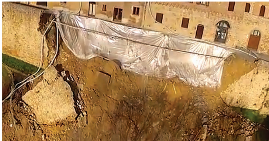
Figura 1. Crollo di un tratto del muro di Volterra avvenuto nel 2014.
