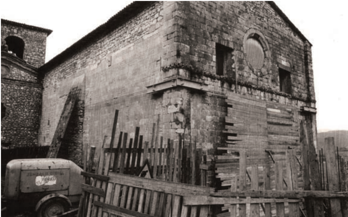
Fig.24: Presidi antisismici provvisori posti sulla facciata dopo il terremoto del 1979 (Archivio Soprintendenza ai Beni Architettonici dell'Umbria)
