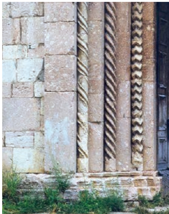
Figg. 9a-b: Porzione sinistra del portale: ripresa generale e di dettaglio con perdita di materiale per scagliatura
