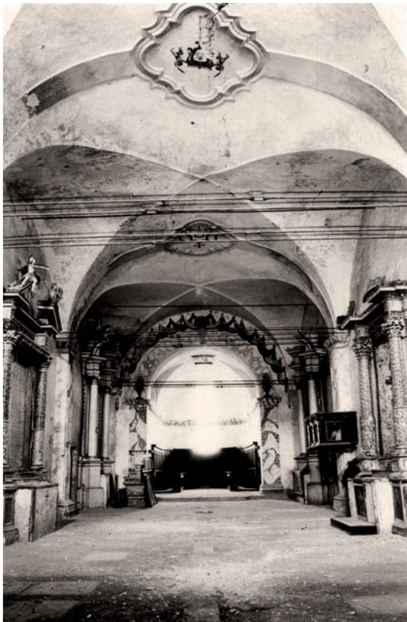
Fig.25: Interno della chiesa dopo le opere provvisorie post-sisma
