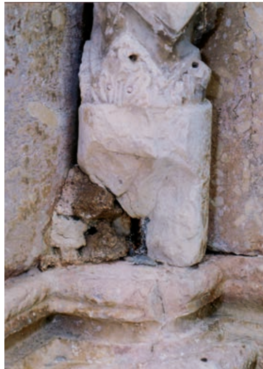
Fig. 6: Erosione della pietra dovuta alla gelività
