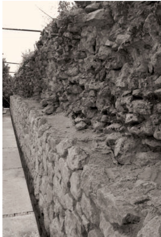
Fig. 22: Cascia (Perugia), la rocca. Parziale ricostruzione del paramento murario del fronte nord, part. (2004).
