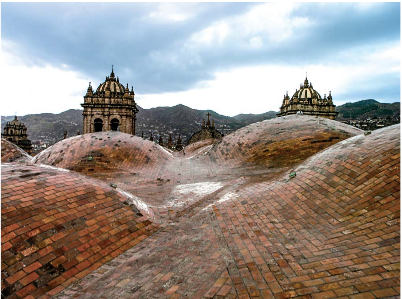
14/ Cattedrale di Cusco: veduta dell'estradosso della copertura voltata, in laterizio a vista (foto dell'A. 2018).
