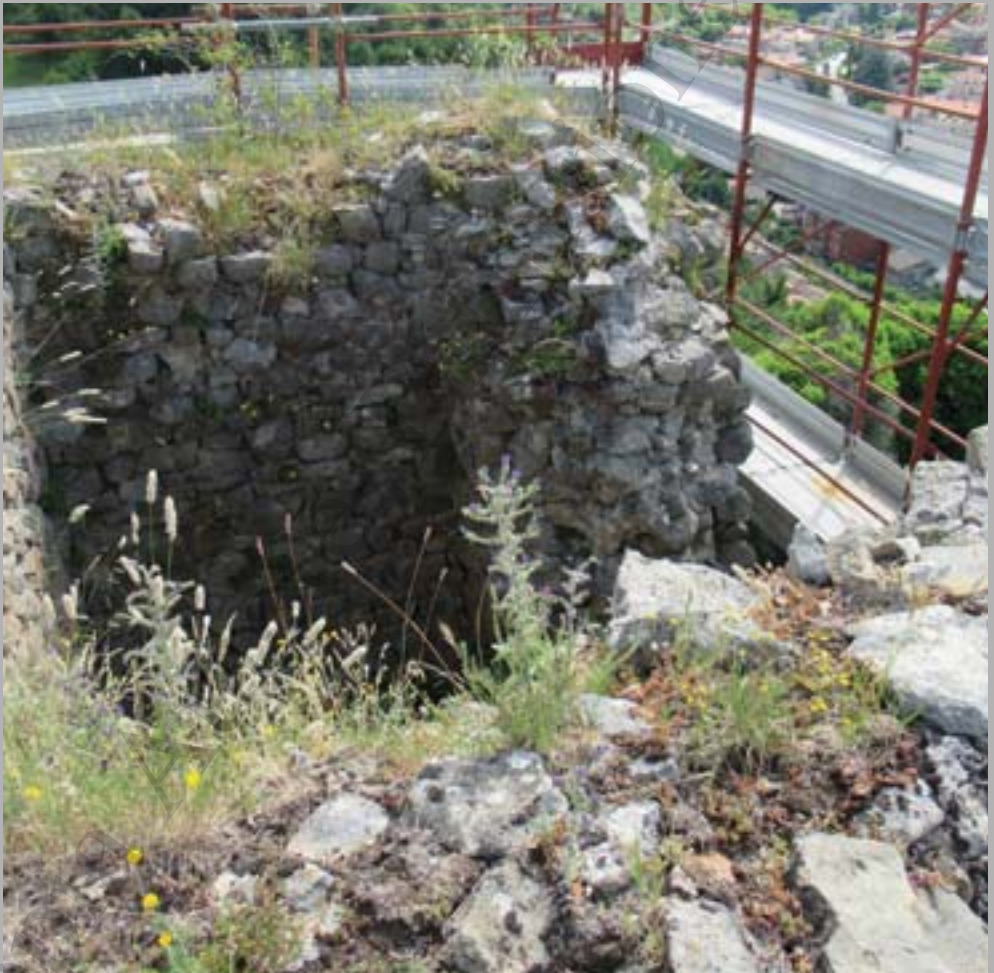
Colle Sant'Angelo di Carsoli, creste sommitali della torre principale prima del restauro (foto S. Cecamore, 2019).
