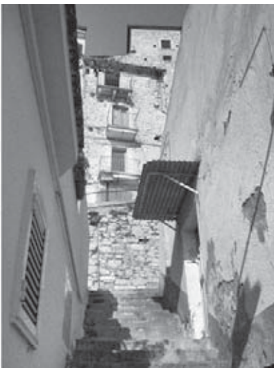
Figure 12-13 – Casoli (Ch), edifici in via Scalelle, con un impiego indiscriminato di malta cementizia e intonacature pesanti, rattoppi e risarciture in cemento, apposizione di tubi e cavi, infissi in alluminio soprastrada.
