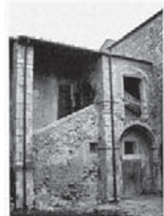
Figura 33 – San Valentino in Abruzzo Citeriore (Pe) , apparecchio murario in bozze di calcare del fronte settentrionale della torre, ascrivibile alla seconda metà del XIII secolo.
