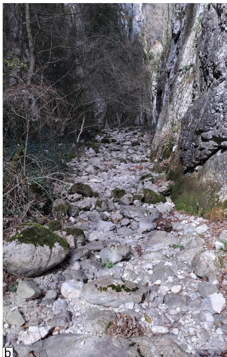
Figura 226. Deposito di frana da crollo costituito da massi isolati di dimensione prevalentemente decimetrica nel settore centro-settentrionale delle gole (930 m s.l.m.). Foto scattata verso nord.
