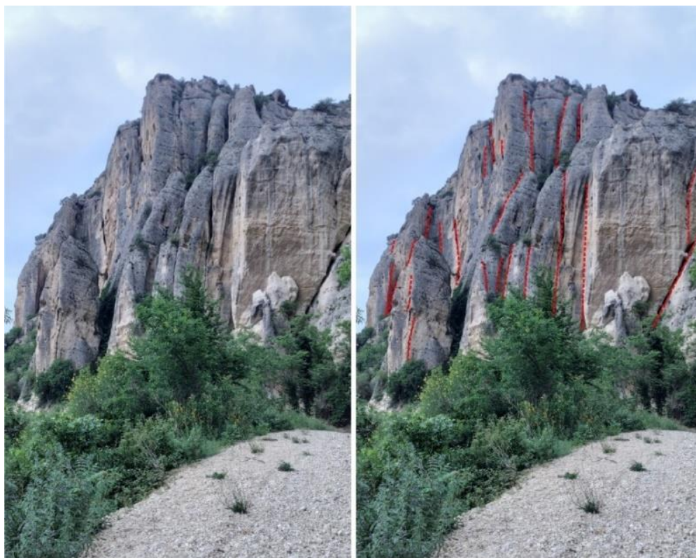
Figura 170. Panoramica del settore settentrionale della rupe di Turrivalignani, in cui è ben evidente il sistema di fratture da sub-verticale ad immergente ad alto angolo verso ovest (indicata dalla linea a tratteggio rossa nella figura di destra; quota scatto 230 m s.l.m.). Foto scattata verso nord.
