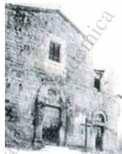
Figura 38 – Luco dei Marsi (Aq), fronte della chiesa di Santa Maria delle Grazie dopo il sisma del 1915 (Archivio fotografico SBAP dell'Abruzzo)
