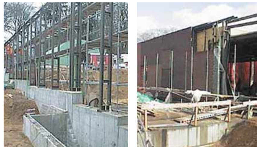
Museo ad Arnhem, cantiere. Struttura metallica e rivestimento in laterizio del lungo muro Arnhem museum, construction site. Steel structure and brick cladding of the long wall
