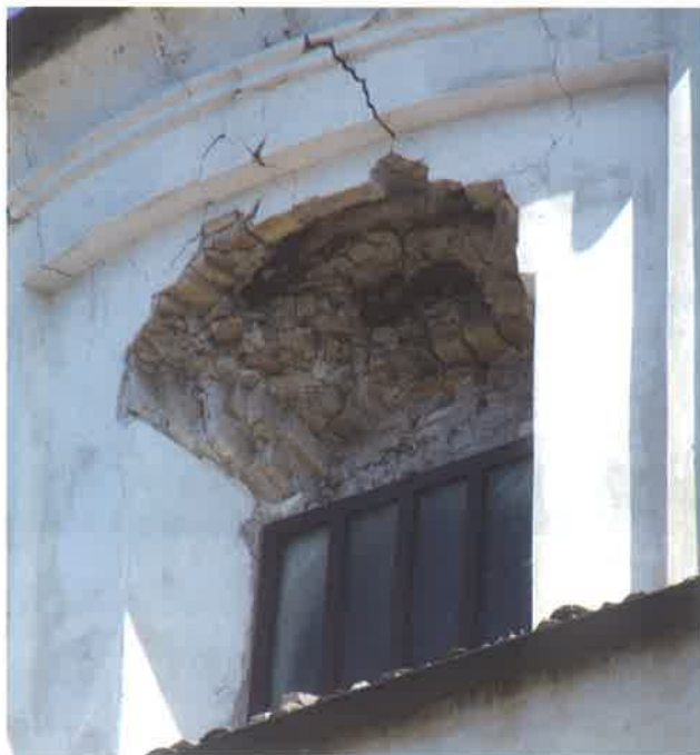
Figg. 10, 11, 12 - Pianella. S. Maria del Carmine, facciata, dettaglio della lanterna e del tamburo (foto dell'A.)
