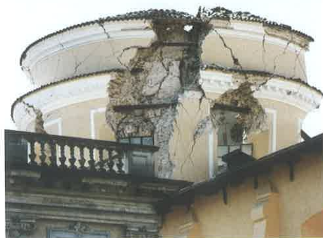
Fig. 15, 16 - L'Aquila. Chiesa del Suffragio (anche detta "delle Anime Sante") e dettaglio del tamburo danneggiato dal sisma del 2009 (foto dell'A.)
