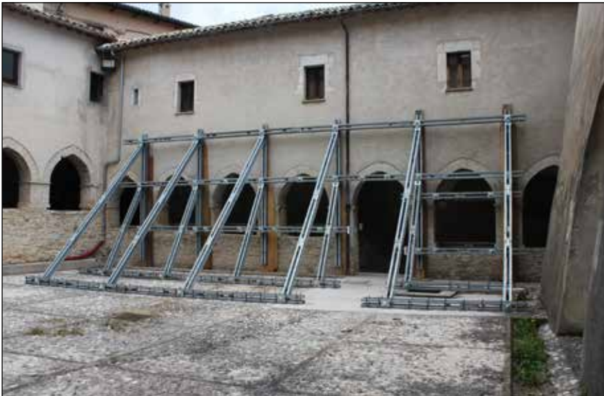
■ Photo 5. Monteleone di Spoleto, S. Francesco, cloister. Temporary works installed by the author (2017) ■ Foto 5. Monteleone di Spoleto, S. Francesco, foişorul mănăstirii. Lucrări provizorii realizate de autor (2017)
