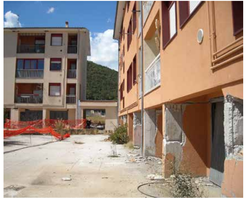
3 Insediamento di Cansatessa. I danni dovuti al sisma, più evidenti ai livelli inferiori, chiamano in causa l'interazione tra le tamponature e i telai
