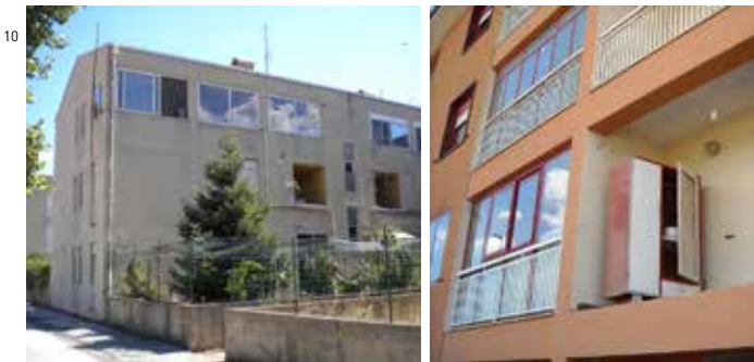
8 Insedimento di Monticchio. Degradamento materico per distacco della pellicola pittorica a causa delle infiltrazioni di acqua dal tetto e per risalita capillare e pioggia battente sulle pareti esterne verticali. All'interno si rileva condensazione superficiale con formazione di muffe e umidità da condensa
