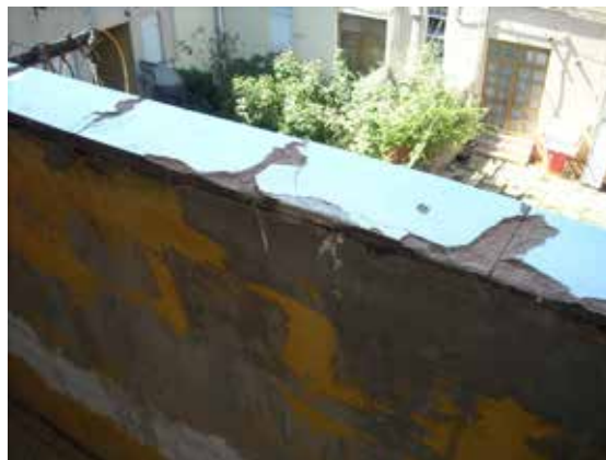
6 Insedimento di Monticchio. Degradamento tecnico e materico: distacco della pellicola pittorica a causa di infiltrazioni di acqua piovana
