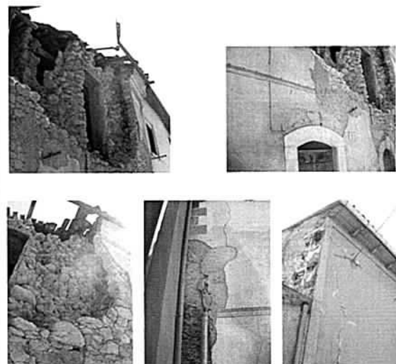
Crollo di un'intera porzione di copertura con il relativo muro sottostante, notevoli distacchi e lesioni diffuse
