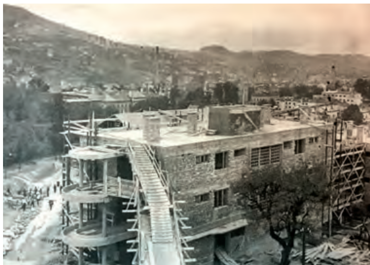
31a. R. Kadić, complesso residenziale a Džidžikovac durante la costruzione, 1954. Foto di I. Fočak
