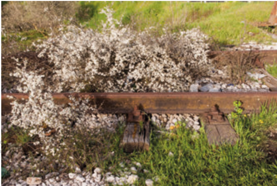
Figure 4-5-6: Immagini della linea ferroviaria Sici-gnano degli Alburni-Lagonegro, chiusa dal 1987. Fotografie di Cas-sandra Cozza.
