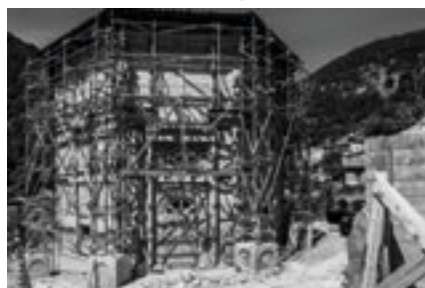
Figure 2: Il tempio della Madonna del Sole a Capodacqua, frazione di Arquata del Tronto dopo il primo terremoto di agosto 2016. Ph: Tommaso Della Dora
