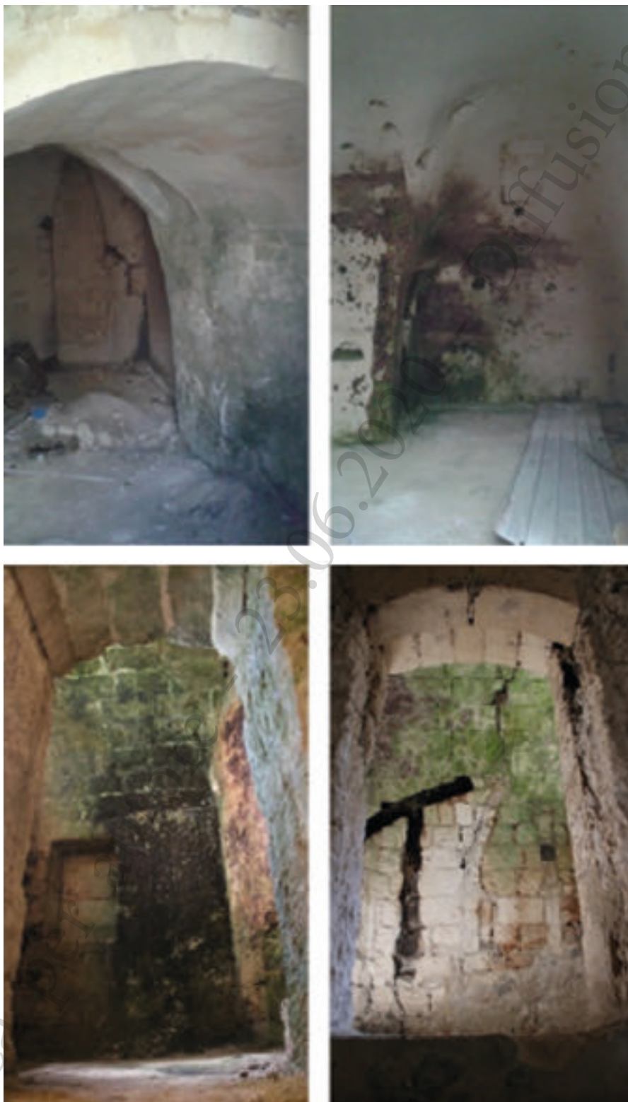
Figure 5: Principali effetti della cattiva irregimentazione delle acque e dei fenomeni di umidità delle murature.
