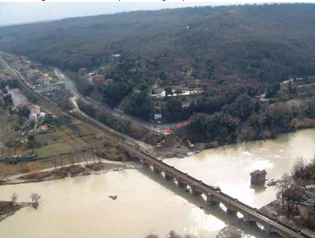
Figura 8 - Foto aerea del ponte sul Sangro dopo il crollo
