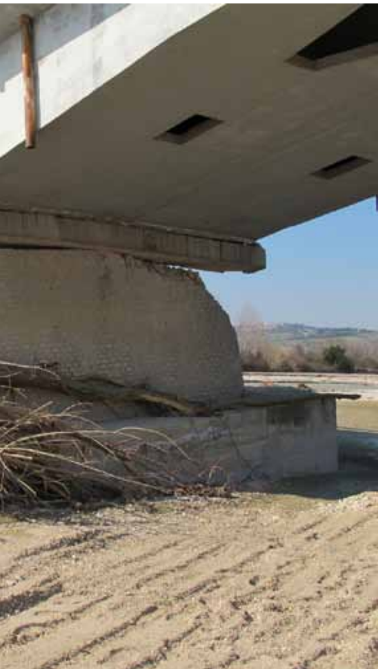
Figura 1 – Il ponte del Fiastra danneggiato a seguito dell'evento alluvionale del 2011
