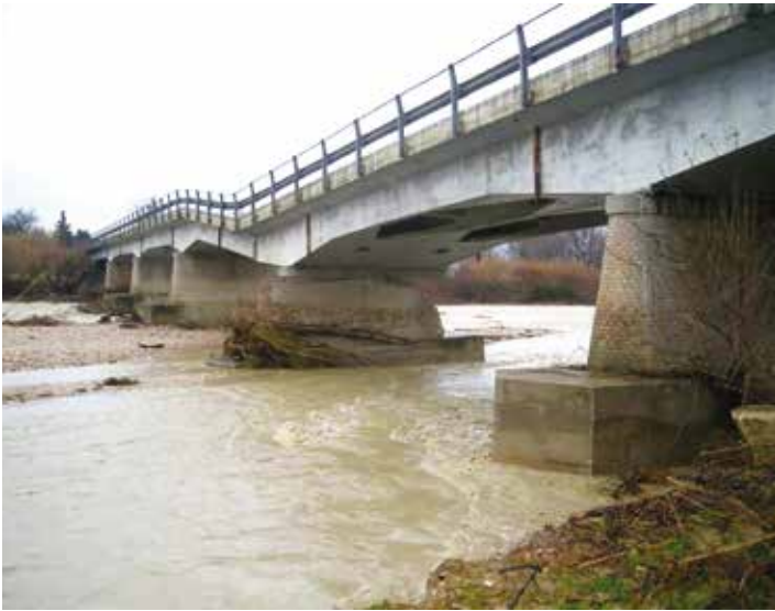
15A e 15B. Il crollo del vecchio ponte sul Fiastra e il nuovo ponte
