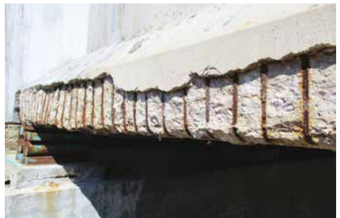
7. Il distacco del copriferro bulbo travi in cap
