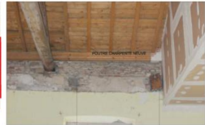
POUTRE FAUX PLAFOND MANQUANTE
